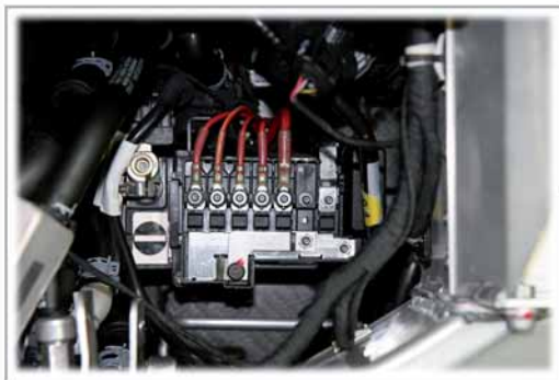
Vorsicherungsträger auf der 12-Volt-Bordnetzbatterie
