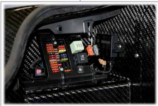
Sicherungs- und Relaisträger, im Kofferraum rechts hinter der Verkleidung
